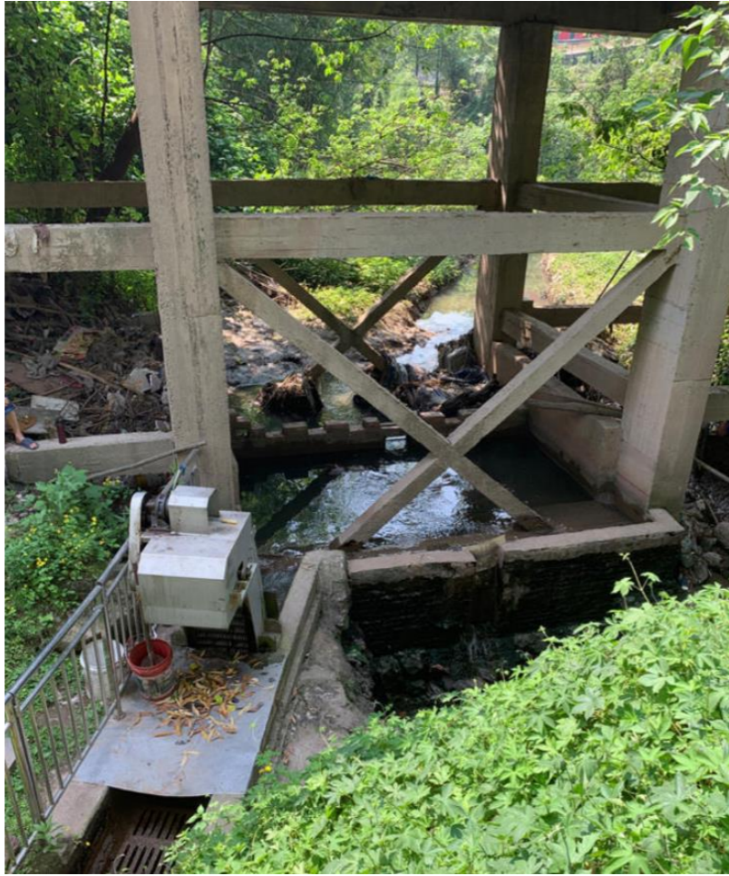
图 7.1-13 茄子溪提升泵站图
