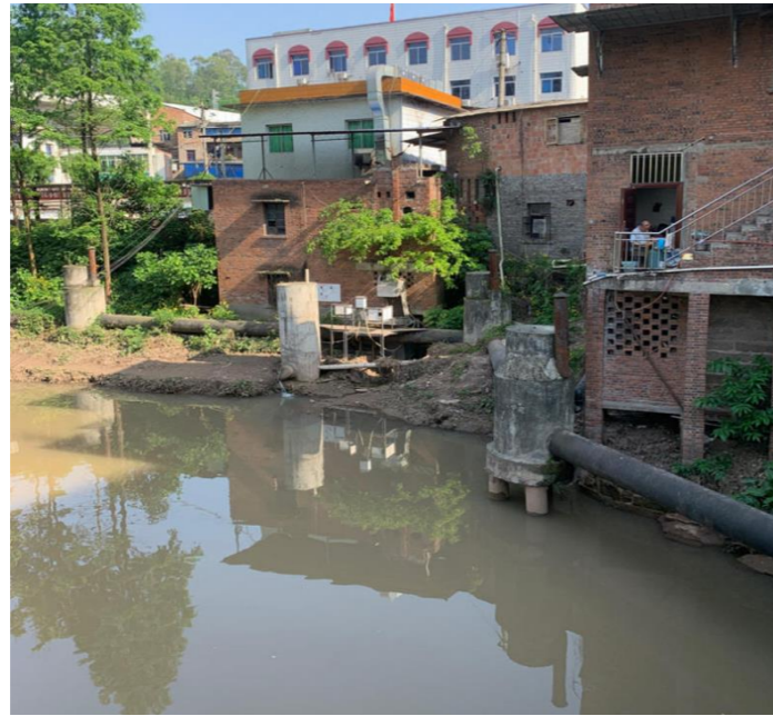
图 7.1-17 跳蹬河提升泵站图
