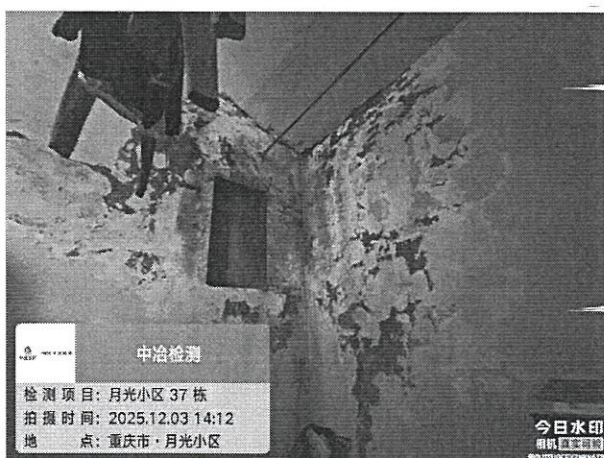
图 4-7：八层 12/D-F、10-12/D 轴墙表面渗水，抹灰脱落
